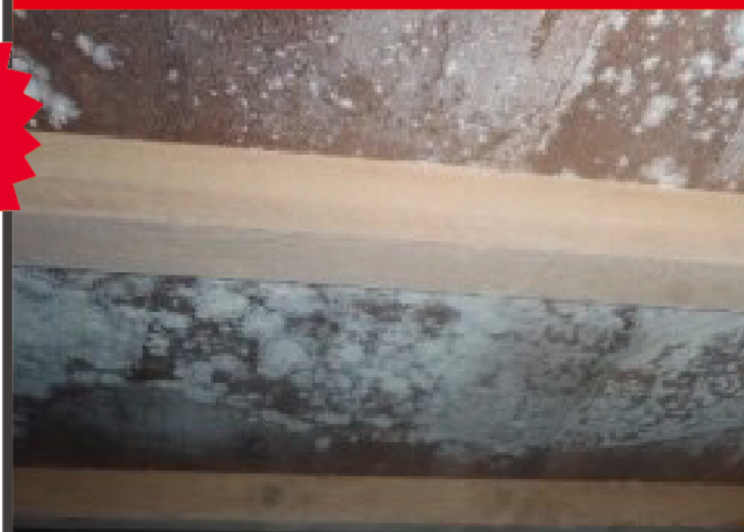
カビによる被害
